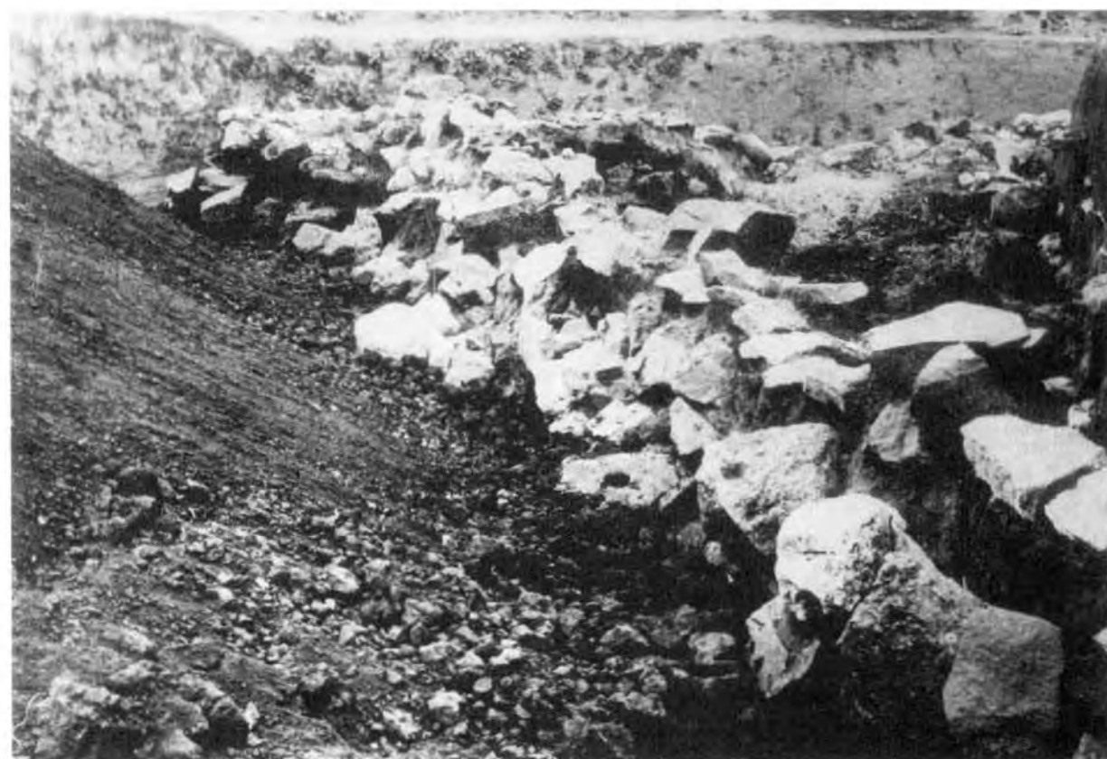
Abb. 17. Žurán - nördliche gestörte Mauer des Segmentes C (unten); oben Reste der nördlichen Mauer dieses Segmentes.
